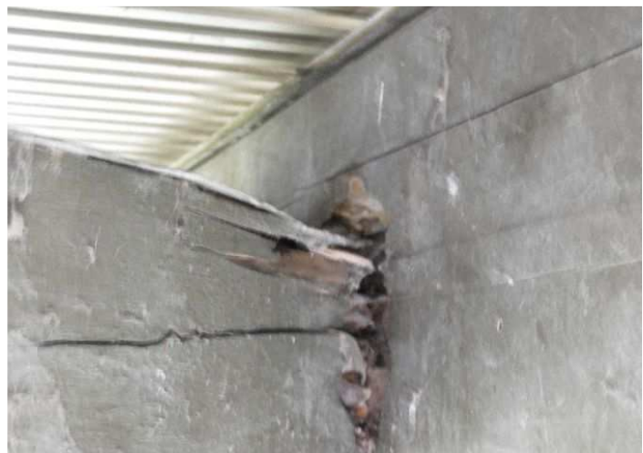
Abbildung 2: Querträger an der Einbindung verfault
