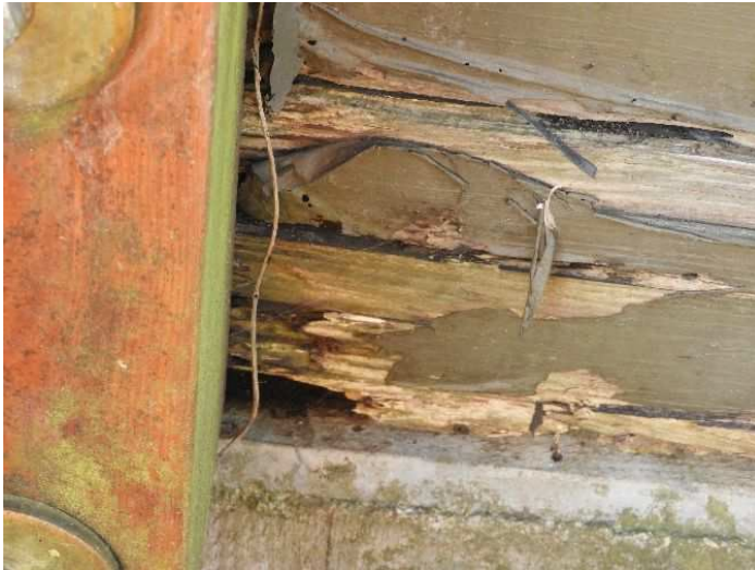
Abbildung 1: Längsträger des Trägerrostes verfault.
